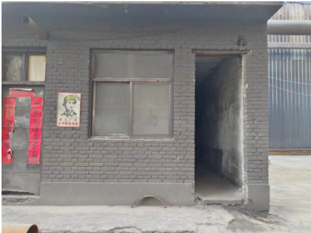
(图 1 事故现场: 电除尘配电室门口)
